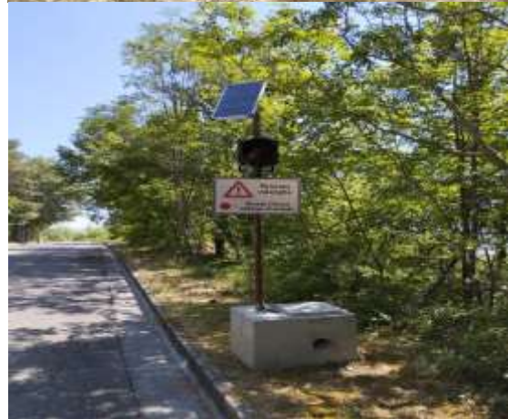
Sistema di monitoraggio ed allarme – Sensori clinometrici elettronici a soglia (Foto sx) e impianto semaforico (Foto dx)
